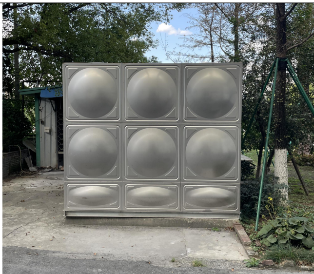
应急池（地上+地下）110m 3
