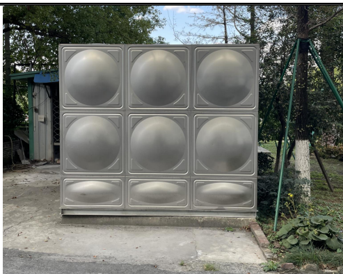
应急池（地上+地下）110m 3
